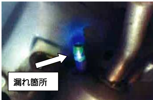
図 1 : 空調の冷却オイル漏れ
